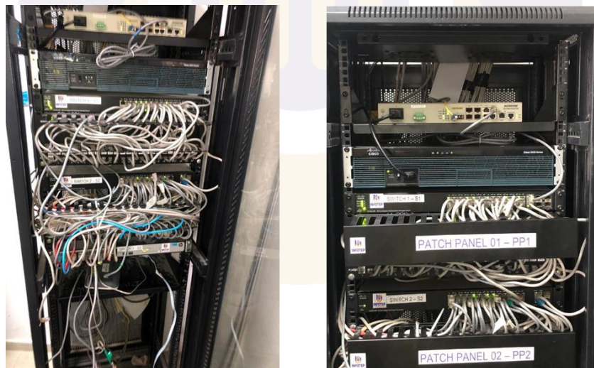
Imagen 3174. Rack principal después del mantenimiento preventivo
